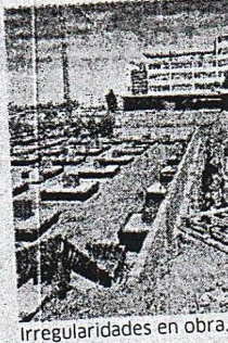
Irregularidades en obra.
