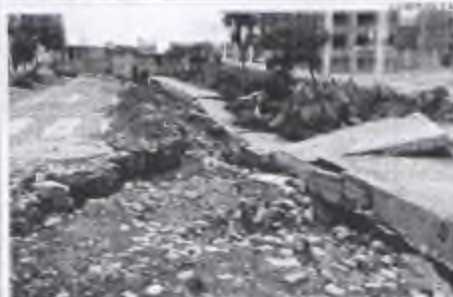
AFECTADAS. Vías de Cayma dañadas tras fuertes aguaceros.
