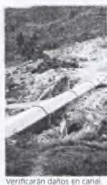
Verificarán daños en canal.
